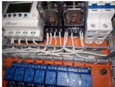
Figura 42. Cableado de la Caja de control
