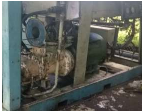
Figura 26: Compresor antes del desmontaje. Elaboración: Fuente propia (2018)
