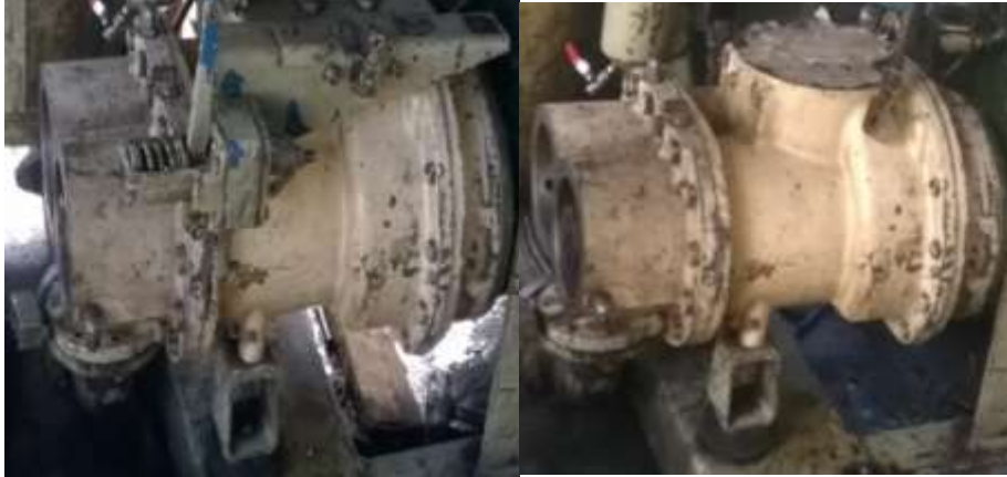
Figura 17: Unidad generación de aire comprimido. Elaboración: Fuente propia. (2018)
