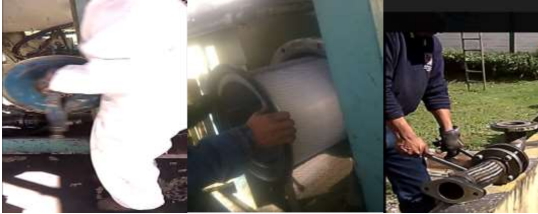
Figura 49: Montaje de la Válvula, Filtro separador. Elaboración: Fuente propia (2018)
