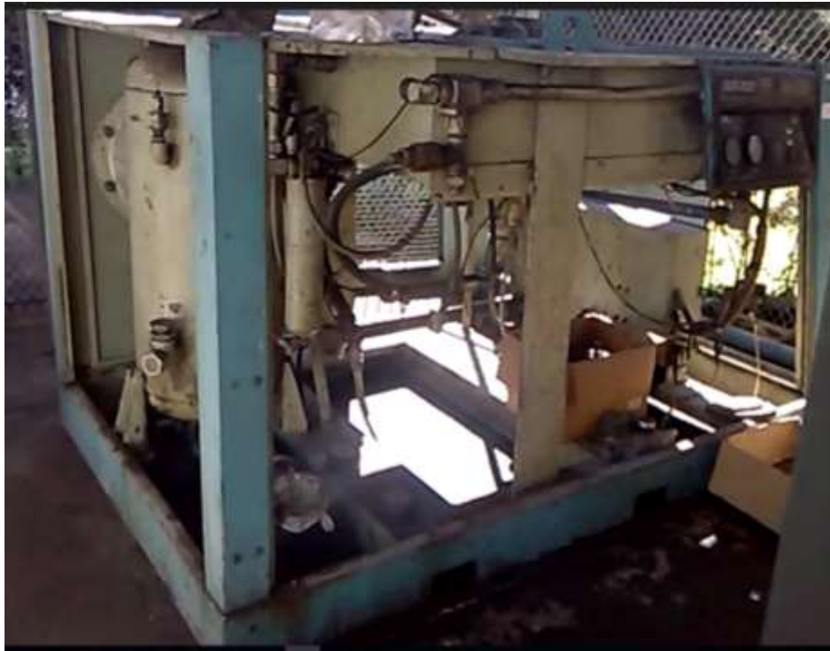
Figura 2: Compresor antes de la reparación. Fuente: Elaboración propia (2018)
