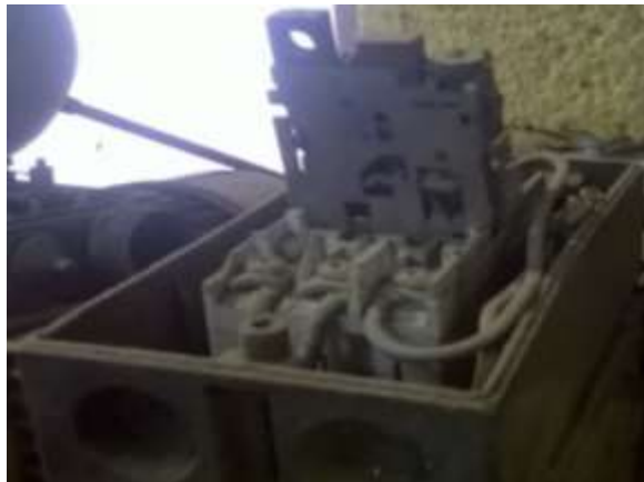
Figura 15: Presostato de control Elaboración: Fuente propia (2018)
