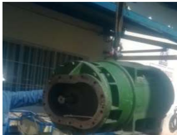
Figura 36: Manipulación del Motor eléctrico de 150 Hp Elaboración: Fuente propia (2018)
