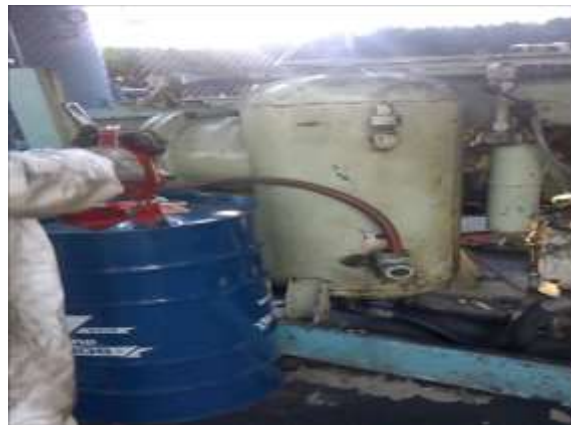
Figura 50: Colocación del lubricante iso 68 Fuente: elaboración propia (2018)
