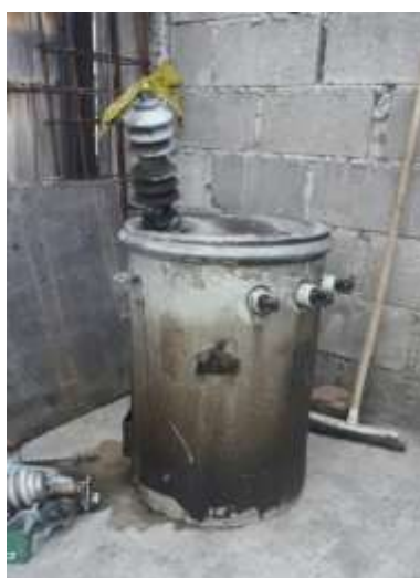
Figura 10: Transformador trifásico (Lenin, 2017).
