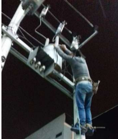
Figura 44: Conexión de bushing de baja tensión (Lenin, 2017).
