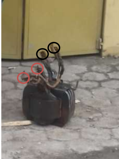
Figura 48: Núcleo, entradas y salidas de tensión del transformador (Lenin, 2017)
