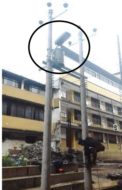
Figura 41: transformador ubicado en la estructura (Lenin, 2017).
