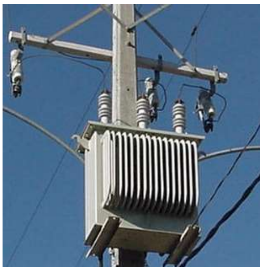
Figura 18: Transformador de distribución sobre poste (Concha, 2015).
