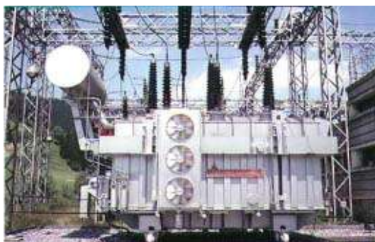
Figura 17: Transformador de Potencia en una subestación eléctrica (Concha, 2015).
