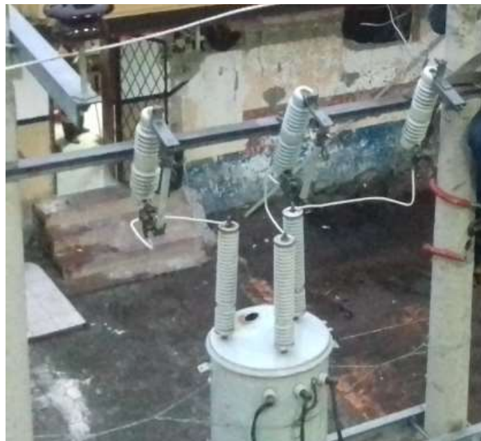
Figura 43: Conexión de bushing de alta tensión con los seccionadores. (Lenin, 2017).
