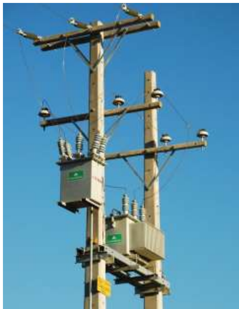
Figura 25: Transformador trifásico (Electroindustria, 2011).
