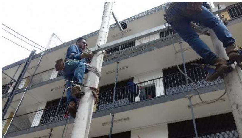
Figura 39: estructura donde se ubicará el transformador (Lenin, 2017).
