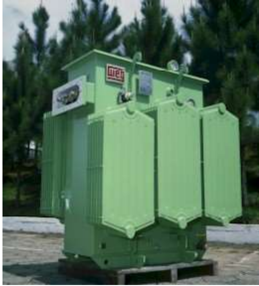
Figura 20: Transformador subterráneo (Concha, 2015).
