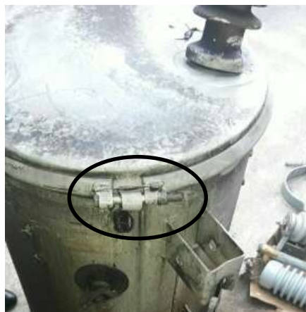
Figura 47: Sello del transformador (Lenin, 2017).
