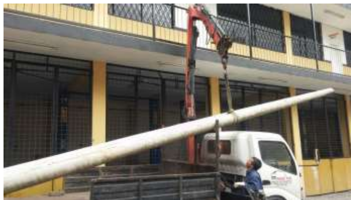
Figura 1: Poste de hormigón (Lenin, 2017).
