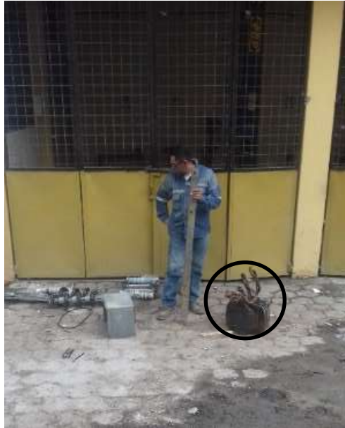
Figura 40: Núcleo del transformador separado del tanque (Lenin, 2017).
