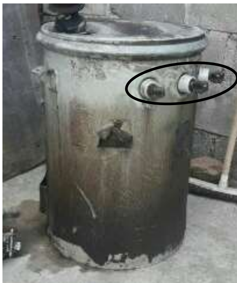
Figura 49: Bushing de salida del transformador (Lenin, 2017)
